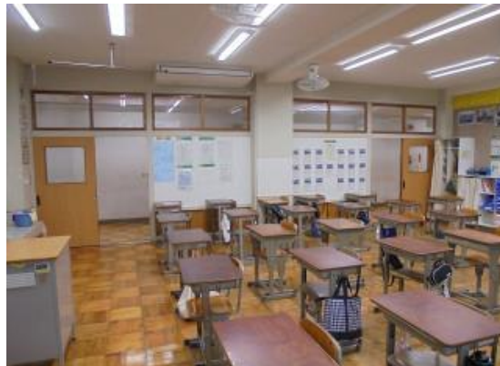
中学校校舎空調設備
