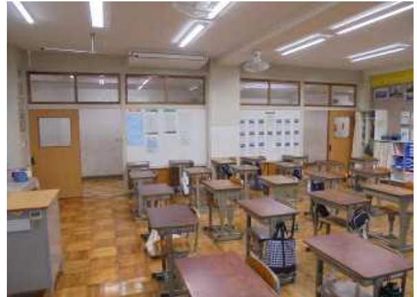
中学校校舎空調設備
