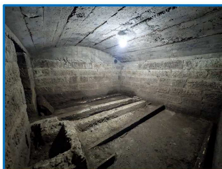
地下無線室 内部
