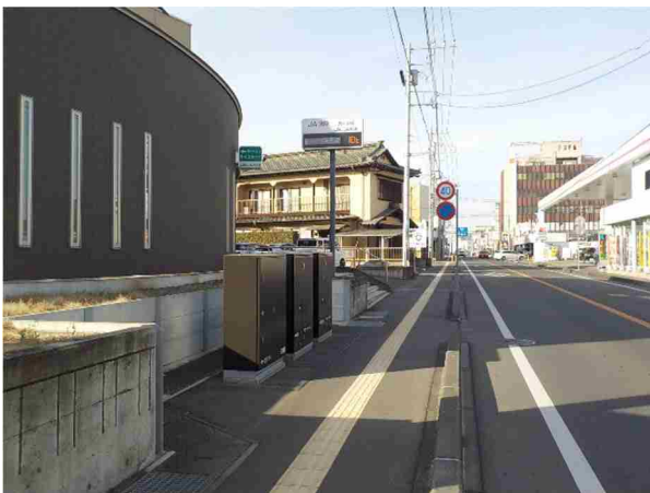
（民地への地上機器設置例（JA 常陸 友部支部））
