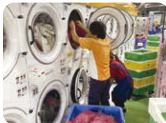
個別乾燥機 洗濯物が混ざらず一つずつ畳めます
