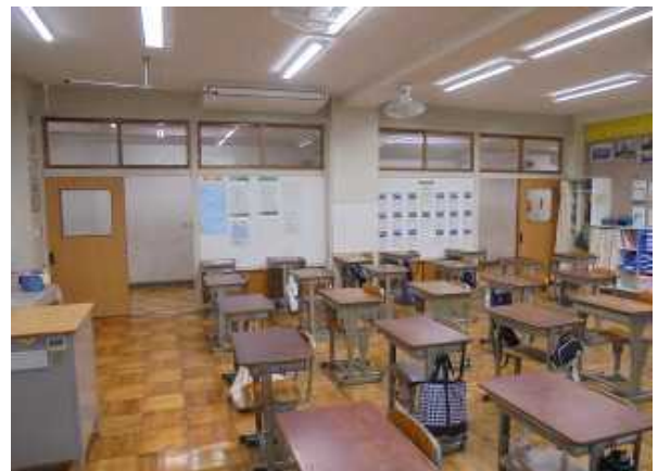
中学校校舎空調設備
