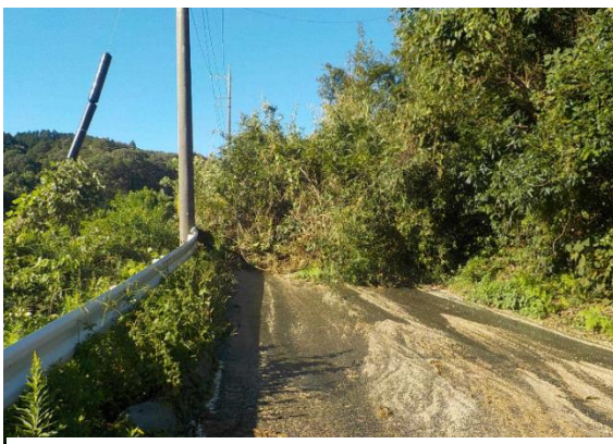
2019(令和元)年台風19号 被災状況 (提供:笠間市 建設課)
