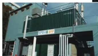
日本初の木質ガス化発熱電供給プラント 2016年完成
