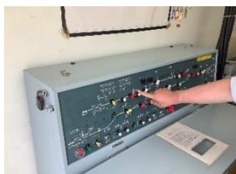
▲転てつ器転換試験 (制御盤)
