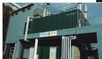
日本初の木質ガス化発熱電併給プラント 2016年完成
