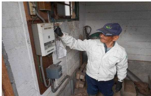
【時期】 4月 【内容】揚水ポンプの点検整備を行った。合わせて、用水路の泥浚いと草刈りを行った。
