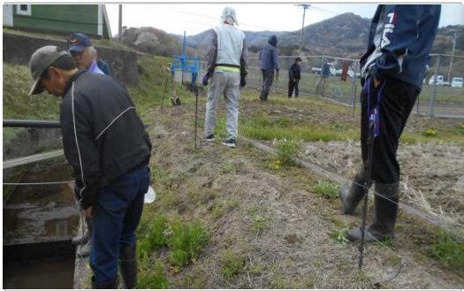
【時期】4月 【内容】農用地・水路・農道の点検および機能診断を実施した。
