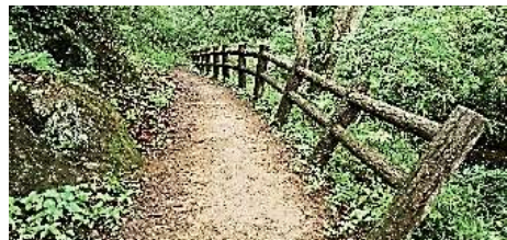
壊れている遊歩道の保護柵
