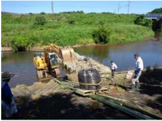
【時期】6月 【内容】潤沼川の第1用水機場の可倒堰が大雨により倒壊しているため、直営で仮の堰（土嚢）を設置した。
