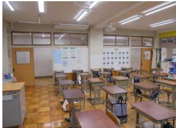
中学校校舎空調設備
