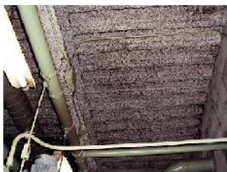
石綿含有吹付けロックウール
