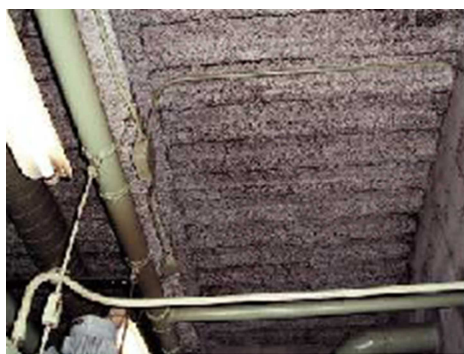
石綿含有吹付けロックウール
