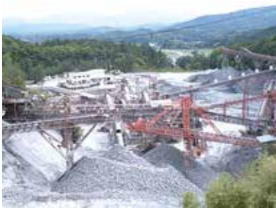
プラントの様子
