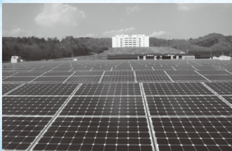
設置された太陽パネル
