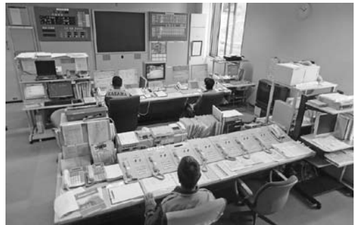
消防本部通信指令室
