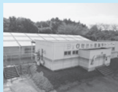
降ひょう被害にあった岩間海洋センタープールの屋根
