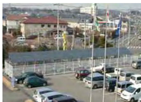
太陽光発電システム
