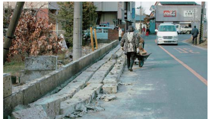
大谷石塀が倒壊（下郷地区）
