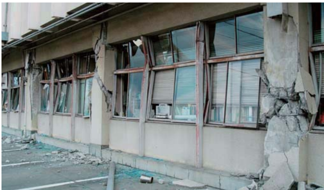
大きな被害を受け使用不能（笠間市役所笠間支所）
