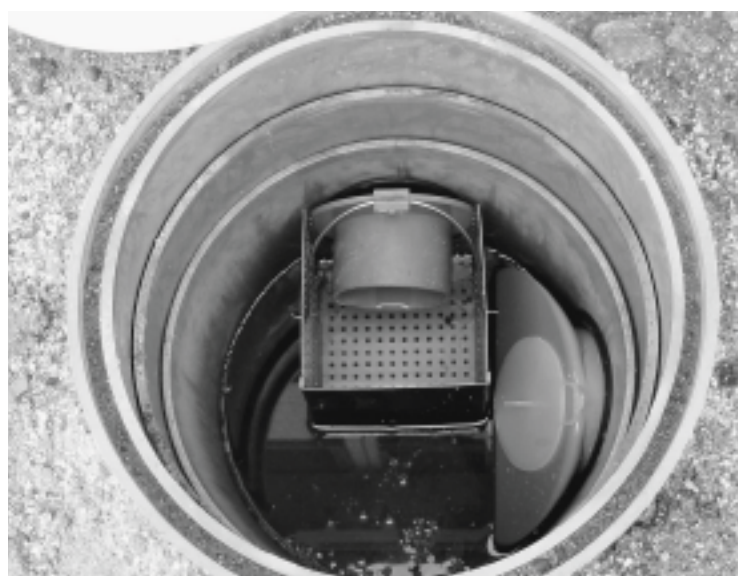
汚水桝に設置される油脂遮断装置
