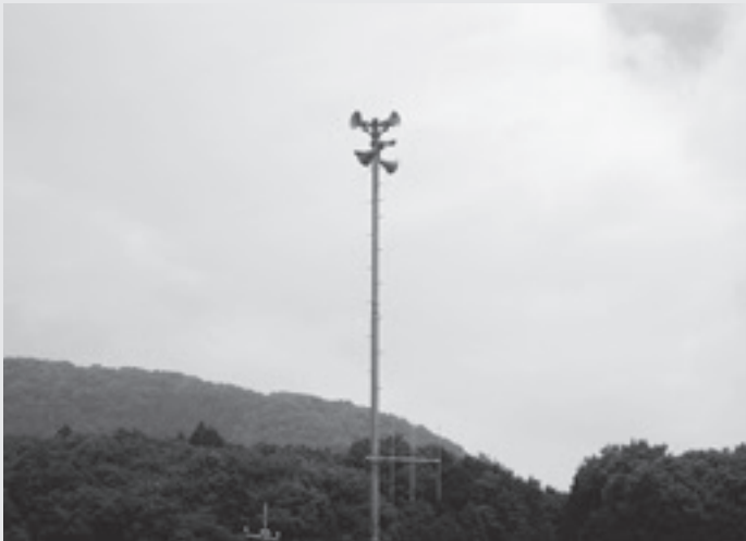
各地区に設置されている防災無線
