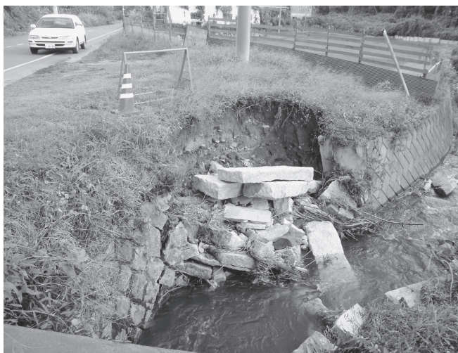
豪雨により崩れた河川の護岸
