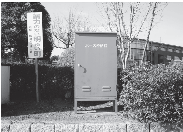
消火栓に併設されたホース格納箱
