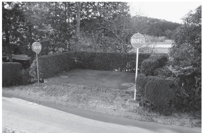
消火栓が併設された防火水槽
