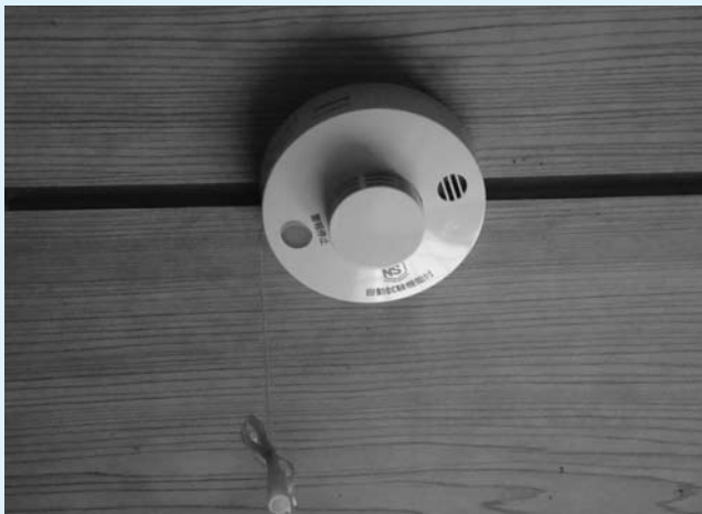
家庭に設置された住宅用火災警報器
