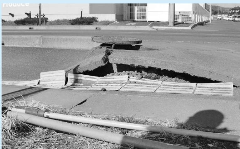
震災により大きく破損した市内の道路
