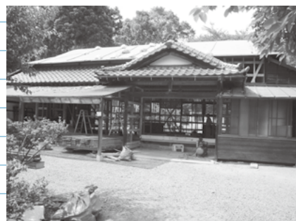
震災により被災した岩間地区の合気道場
