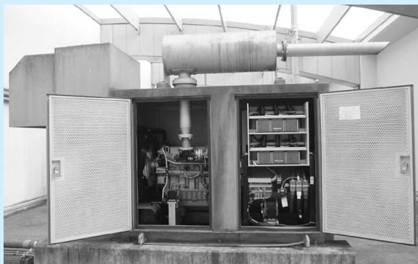
非常用の自家発電装置(岩間支所)
